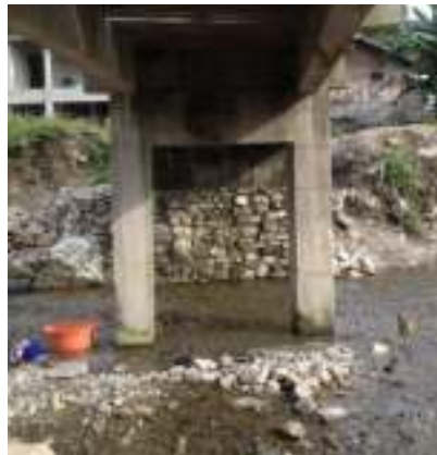
Gambar 26. Dasar Sungai Nasiri di bawah jembatan pada tgl. 5 Maret 2017
